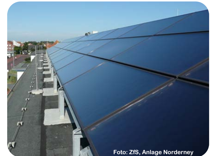
Foto: ZfS, Anlage Norderney
